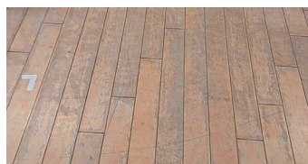
ささくれ(剥離)
